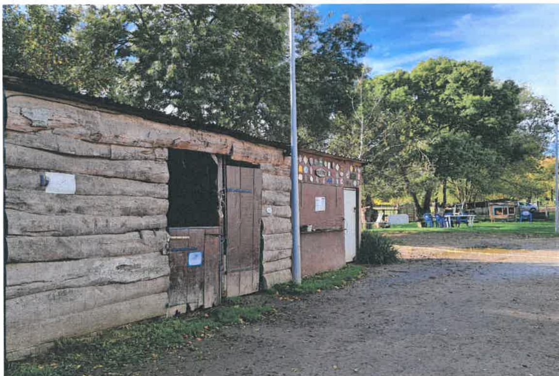
UN BOXE, UN ATELIER ET UNE SELLERIE EXISTANTS DEPUIS LE DÉBUT ENTRETENU SANS MODIFICATION
